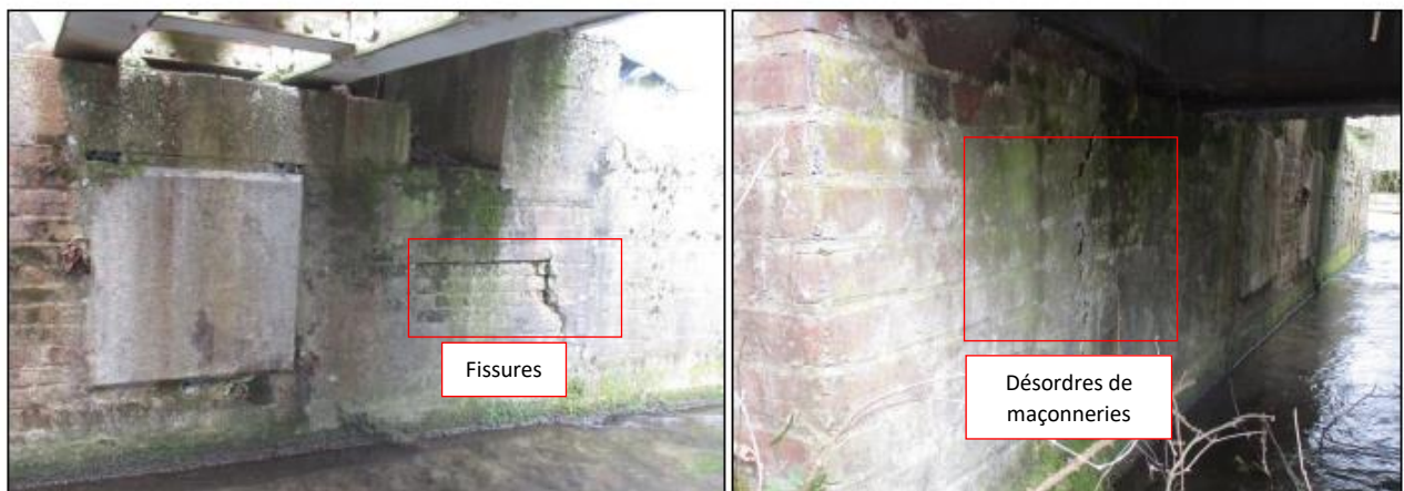
Figure 4 : Ligne 325 000 – PRa pk 144+388 – Photographies des désordres sur l'ouvrage : fissures et désorganisation des maçonneries des culées
